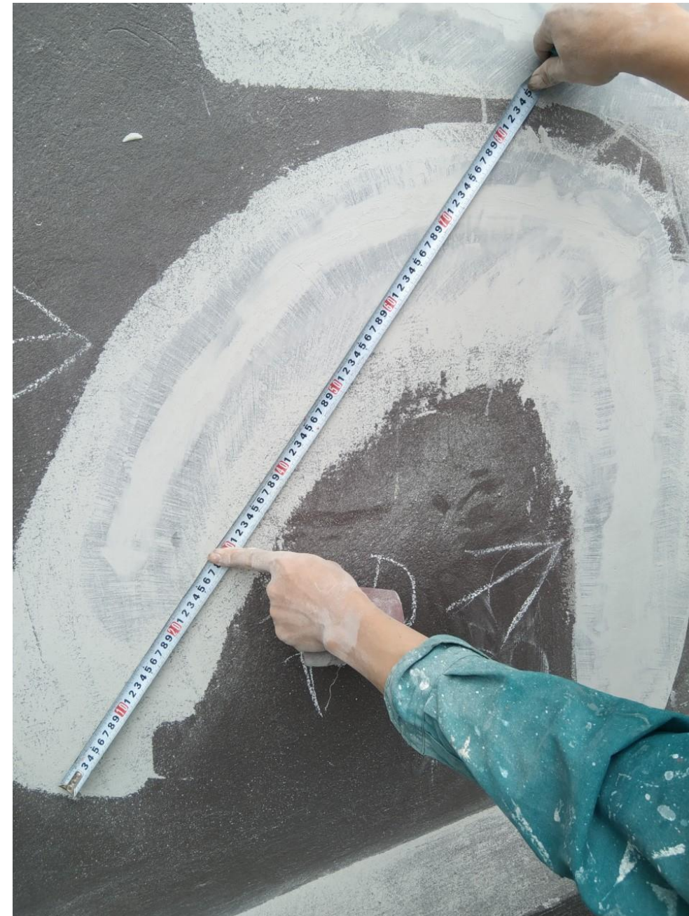
XMC Tower | Nứt thấm tường ngoài nhà
