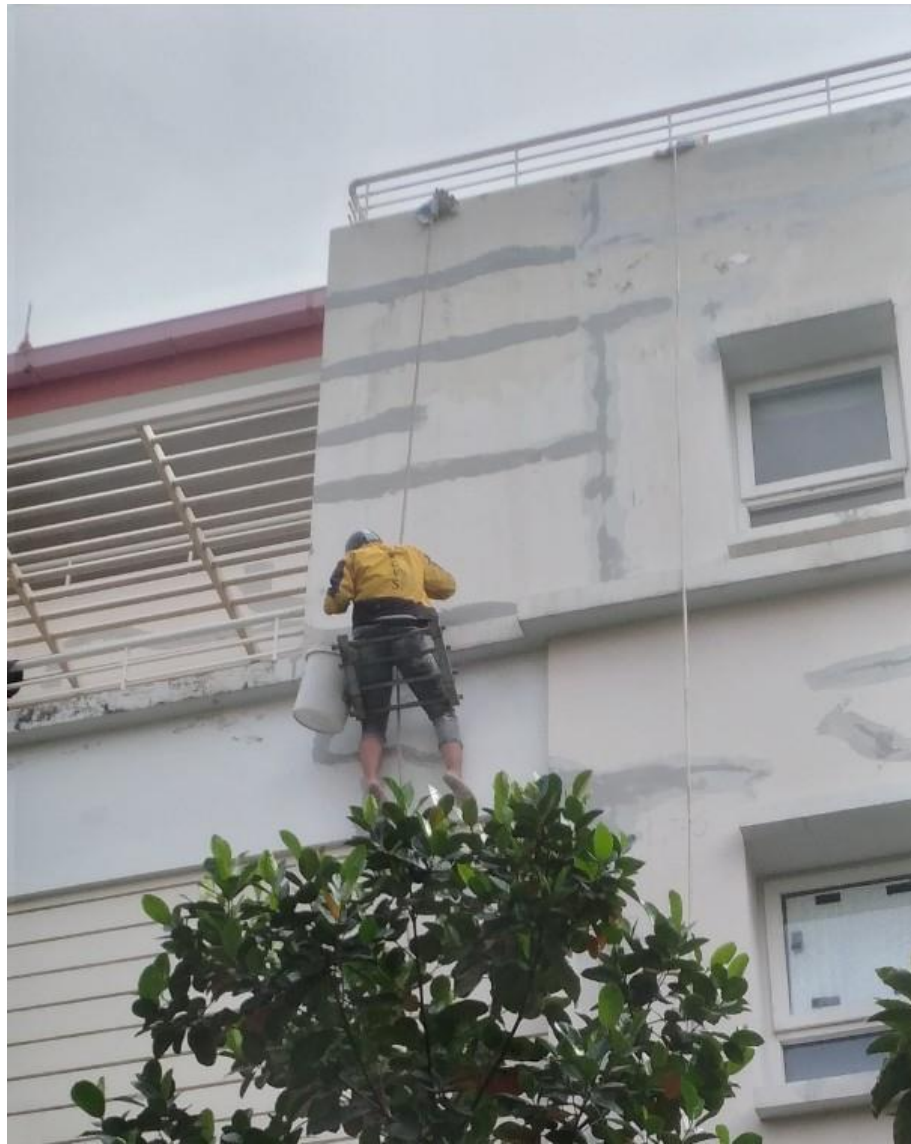
Nhà LK An Khánh | Nứt thấm tường trong và ngoài nhà
