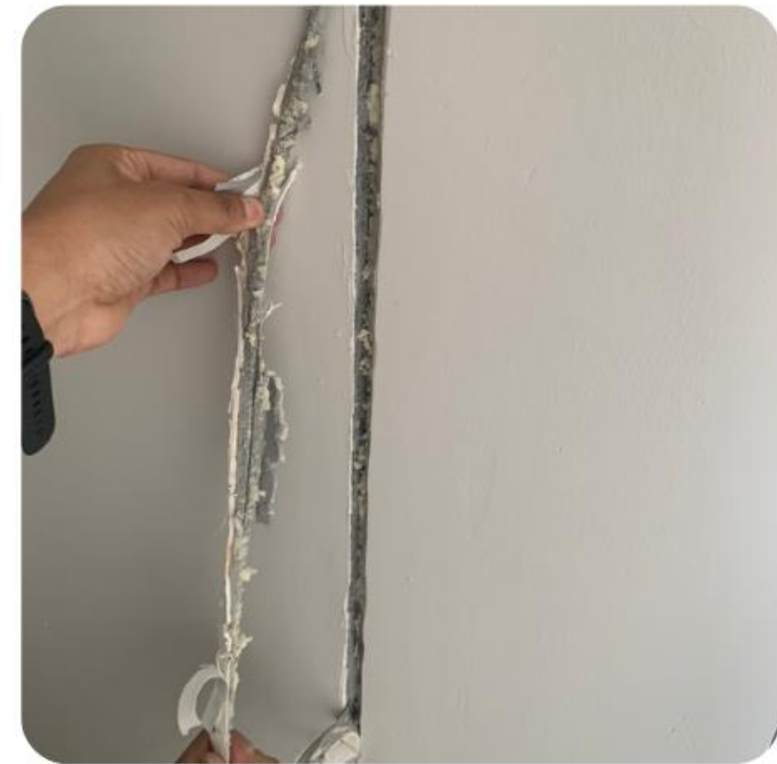
Nứt tách lớp dọc khe nối tấm tường (ALC, Acotec, Cemboard, EPS) sau khi xử lý bằng keo PU
