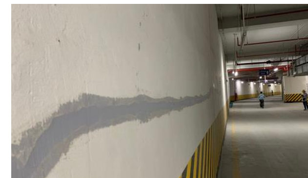
Nứt quanh lanh tô cửa Nứt ngang tầng hầm
