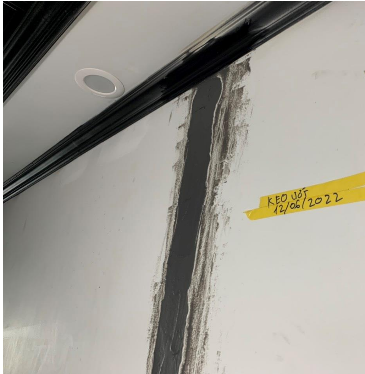
Du Thuyền 5 sao RITA | Nứt dọc tấm Cemboard/Ucoboard
