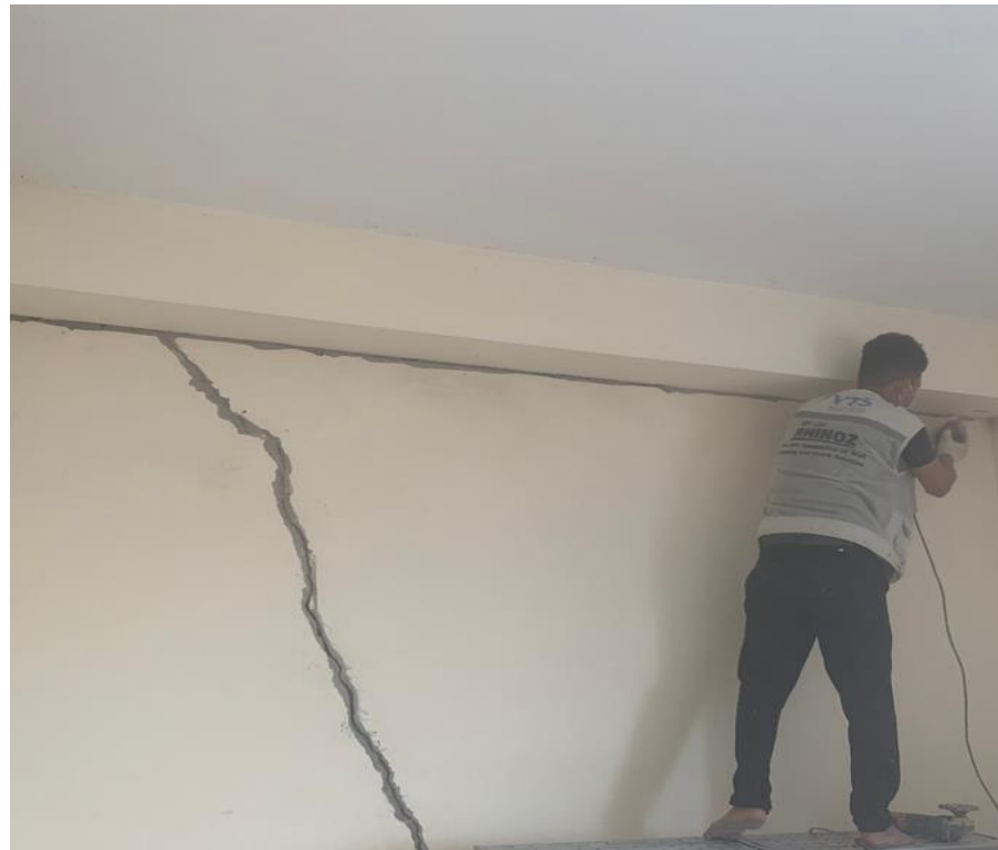
Nứt Cổ trần (tách lớp đỉnh tường gạch và đáy dầm)
