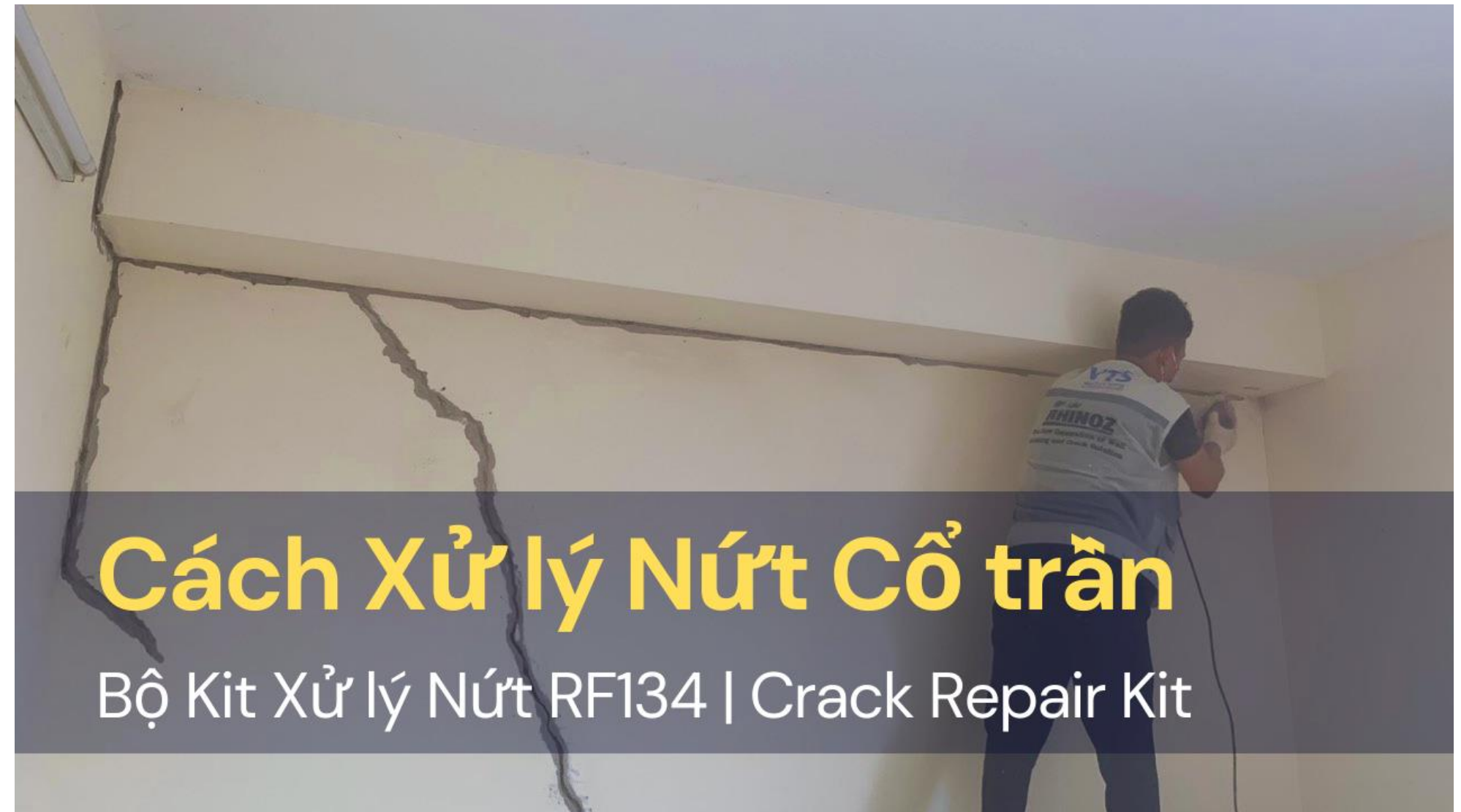
Thủy Lợi Building | Nứt thấm tường trong và ngoài nhà
